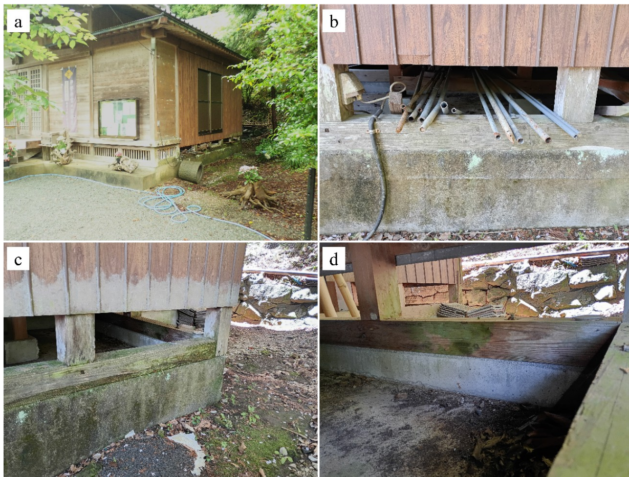
図 1. トゲナナフシの死骸が確認された神社拝殿の床下空間（a-c：調査範囲外周部の状況，d：床下内部の状況）
